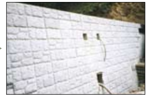
4 打設高は1.5m未満とする。(パネル1枚に4本のサポート筋の場合)
