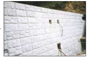
4 打設高は1.5m未満とする。(パネル1枚に4本のサポート筋の場合)
